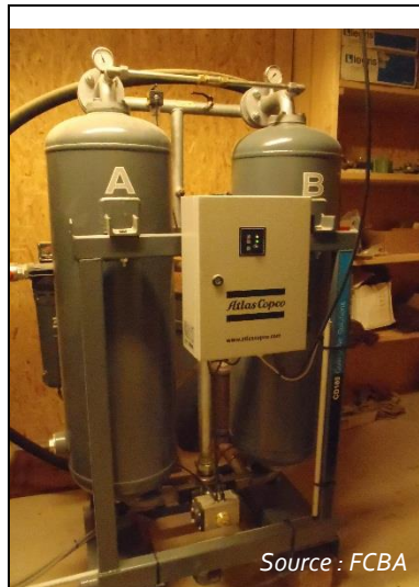
« Assécheur » d'air pour compresseur à air comprimé
