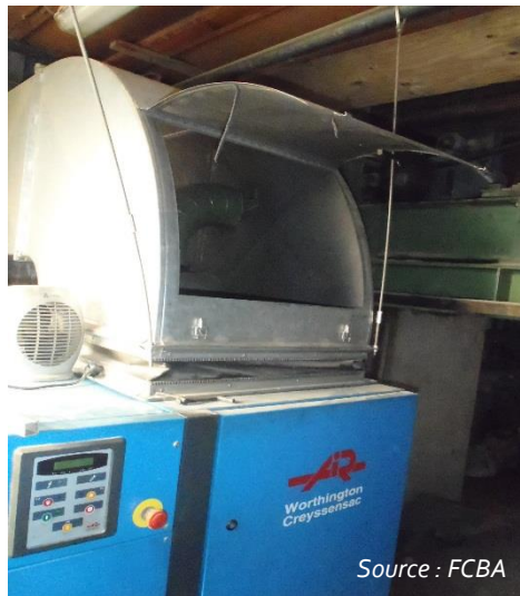
Système de récupération de la chaleur du compresseur
